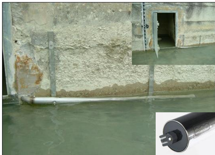
Figura 19. Instal·lació d'un sensor de terbolesa (riu Isàbena) òptic tipus MacVann amb escombreta de neteja
